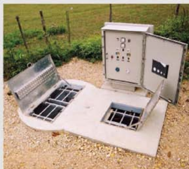
POSTE DE RELEVAGE DES EAUX USÉES DE COUHÉ (86)
